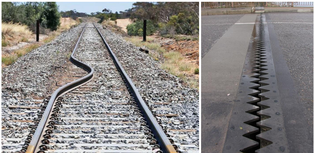
Hình. Biến dạng đường ray và khe hở giữa hai nhịp cầu
